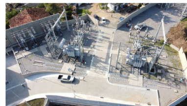
Com a entrada dessa nova subestação será possível ter maior confiabilidade no fornecimento de energia para os clientes desses municípios. Foto: Divulgação
